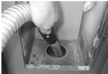
Fig. 32 - Limpieza alojamiento brasero
